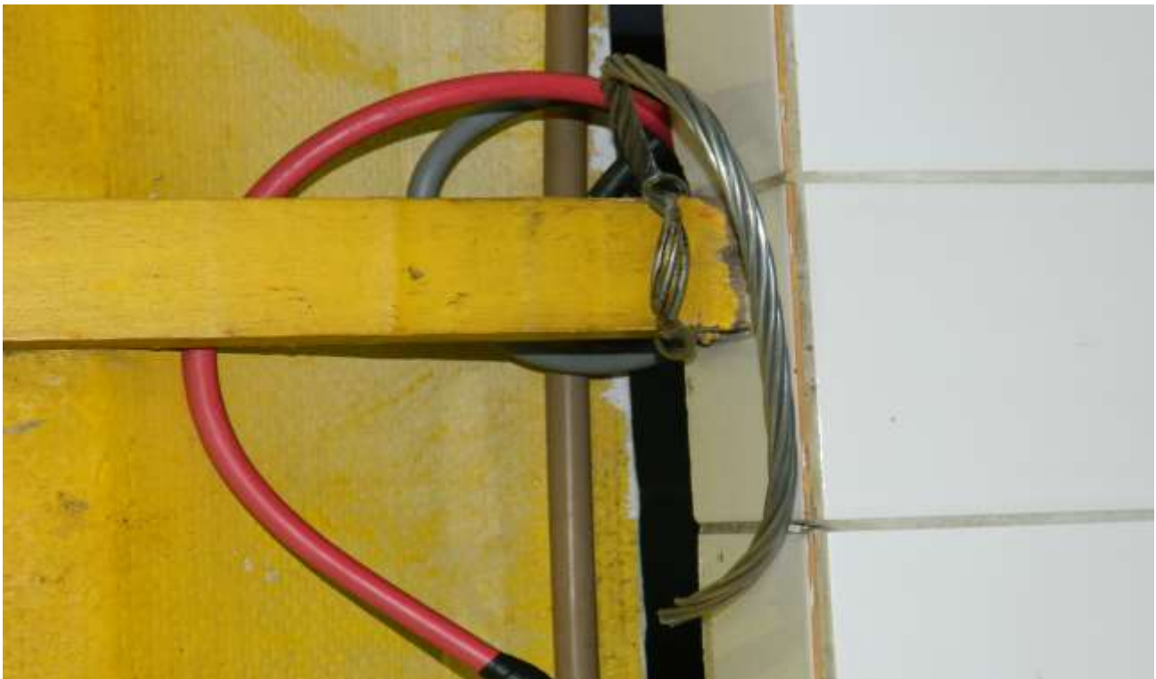
Foto 14 - Cabo de alta tensão amarrado na copa no segundo pavimento, situação incorreta comparada com esta Norma.
