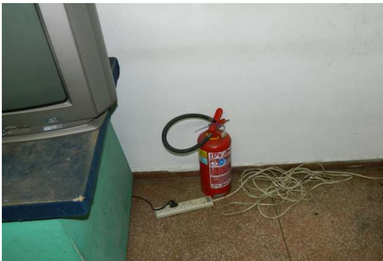
Foto 19 - Extintores além de vencidos e descarregados estão escondidos
