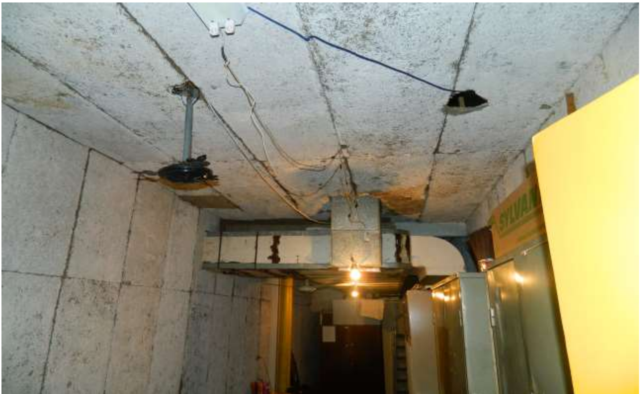
Foto 13 - Sala de descanso para servidores e terceirizados em péssimas condições
