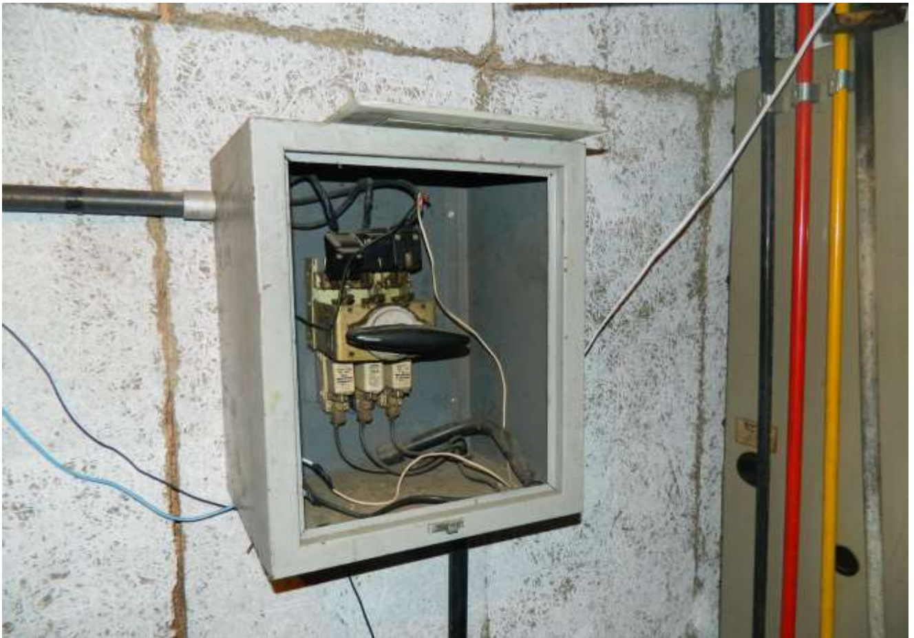
Foto 12 - Caixa de distribuição exposta
