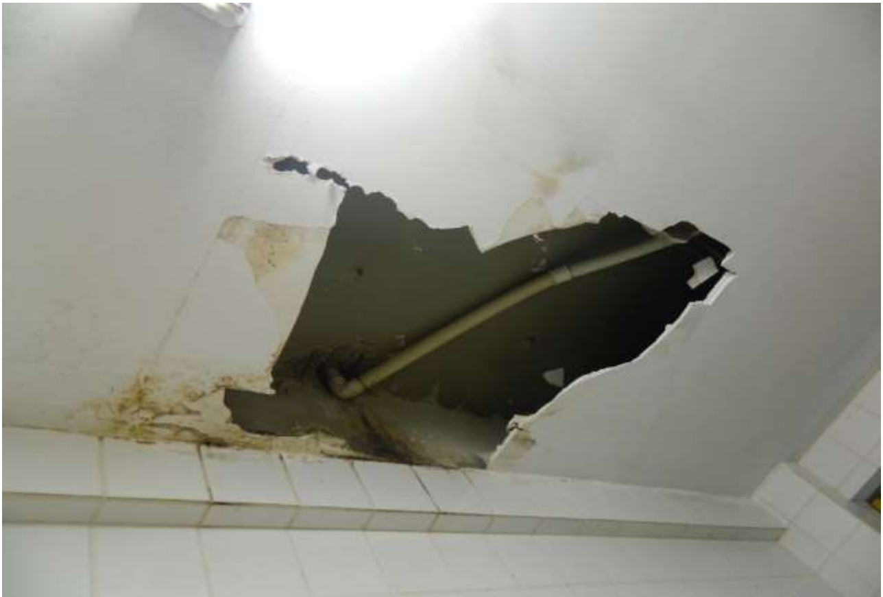
Foto 05 – Buraco no gesso e infiltrações no teto do banheiro masculino
