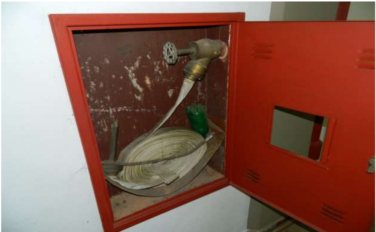
Foto 17 - Mangueira de incêndio deteriorada
