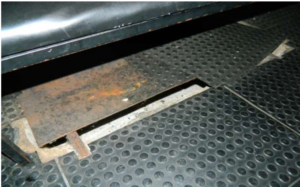
Foto 03 - Piso da sala de descanso de terceirizados (buraco na laje)
