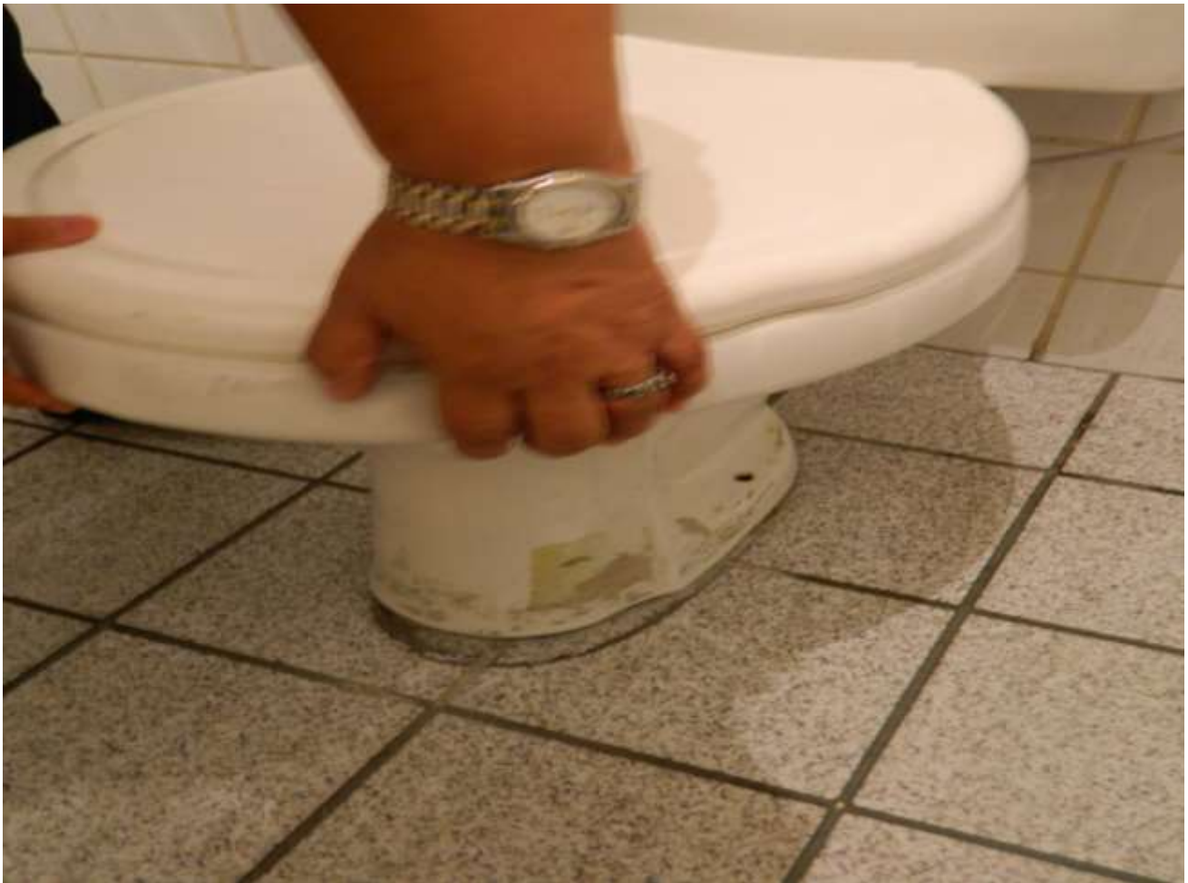
Foto 06 - Vaso sanitário do banheiro feminino e masculino solto
