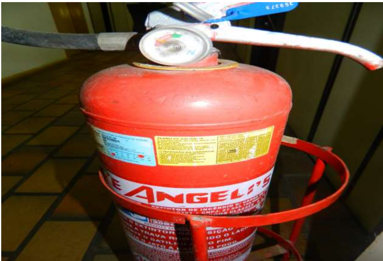
Foto 18 - Extintores vencidos e descarregados (manômetro com ponteiro no vermelho).
