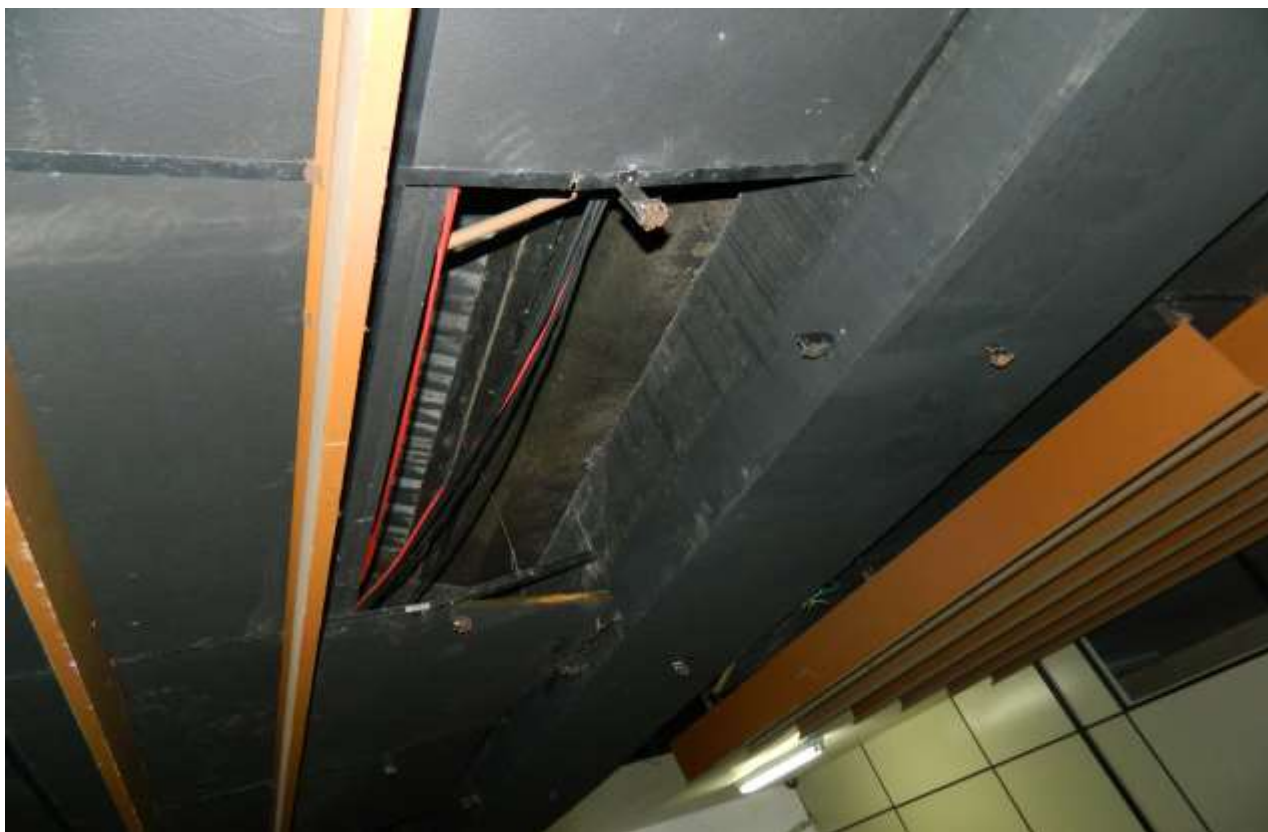
Foto 04 – Buraco no teto do saguão, por onde vasa água da chuva
