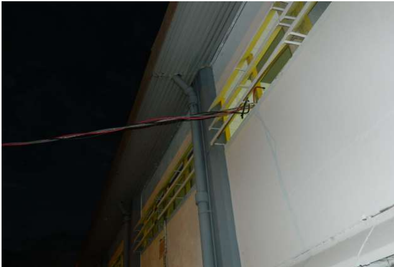
Foto 16 - Cabo de alta tensão que vem do poste que esta na copa, risco de choque elétrico
