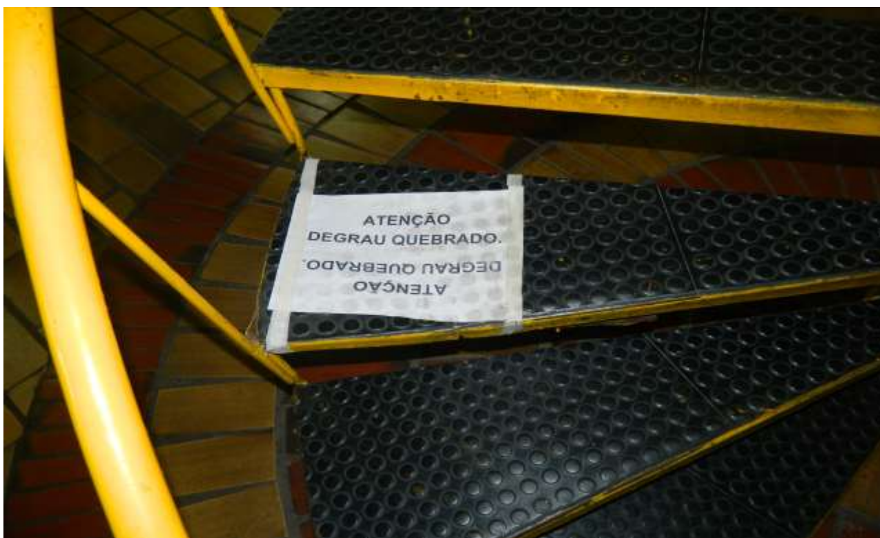
Foto 23 - Degrau quebrado da escada caracol
